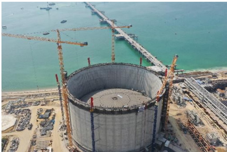
泰國 PTT LNG接收站
